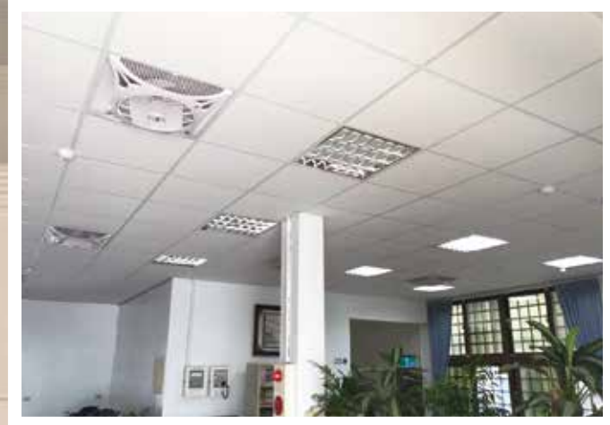
▲天花板裝設風扇增加空氣流通
